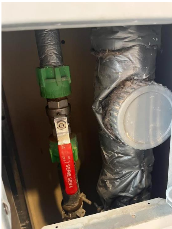
Slika 1. Postojeća uzvodnica sanitarne mreže i kanalizacijska vertikala
