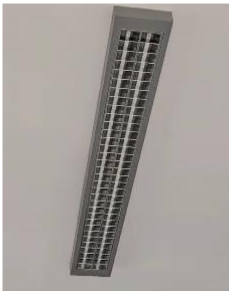
Slika 1 – Postojeća rasvjetna tijela sa T8 fluo cijevima
